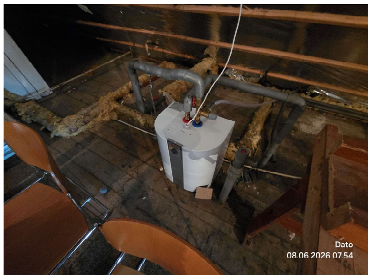
Vandvarmer på loft i gul bygning
