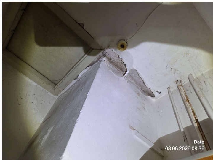
Fugtskade ved skorsten
